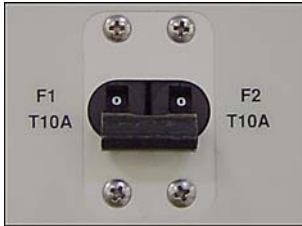
Fig. 7 Automatic mains fuse
